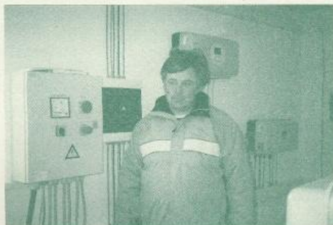
Franc Stopar v prostoru za usmerjanje električne energije, marec 2009, foto: A. Repanšek
